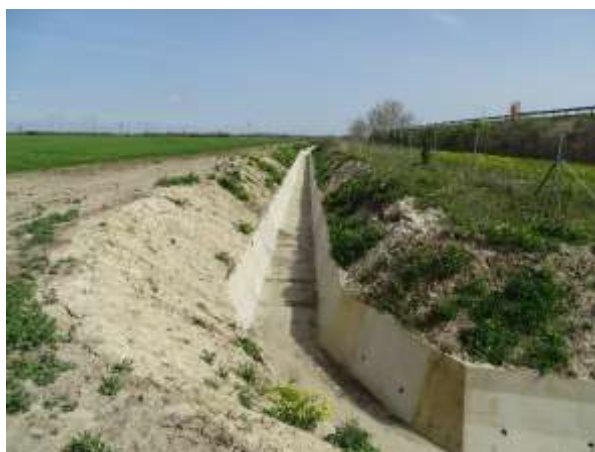
Az Öthalmi I. mellék csatorna frissen burkolt, de elbontásra került szakasza az autópálya mellett
